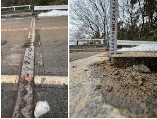
写真-44 伸縮装置の段差
