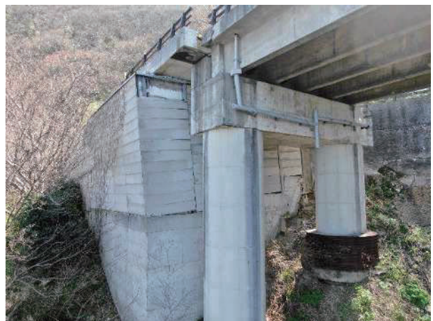
写真-43 橋台背面 EPS 盛土変形
