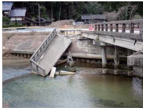
写真-4 地震動による上部工の落橋 (酒見大橋)
