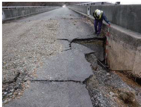
写真-3 橋台背面土砂の流出
