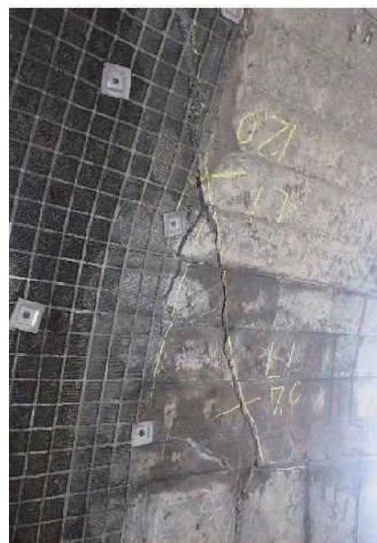
写真-12 七尾側坑門工のひび割れ、目地開き
