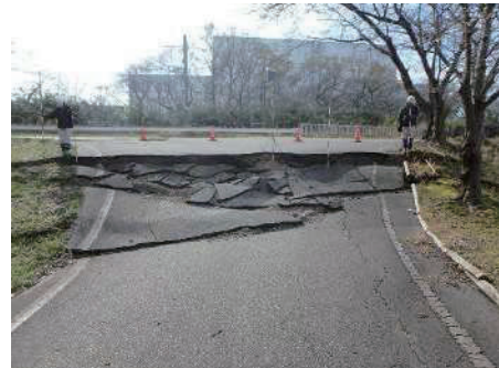
写真-7 町道の被災状況
