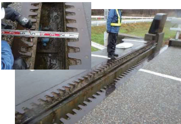
写真-8 才田大橋 伸縮装置破損・遊間拡大
