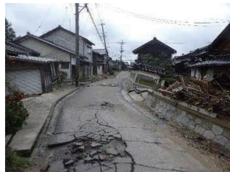
写真-13 液状化した町道・民家の被災状況
