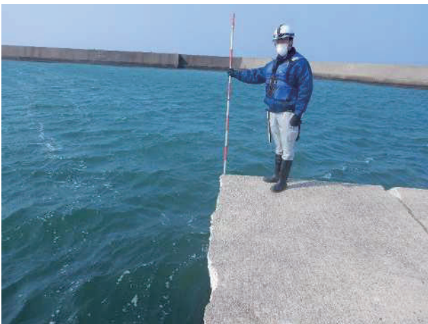
写真-3 津波による突堤先端の消失
