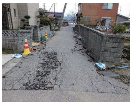
写真-1 市道の被災状況
