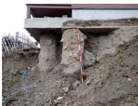
写真-9 建物杭基礎部での地盤崩壊
