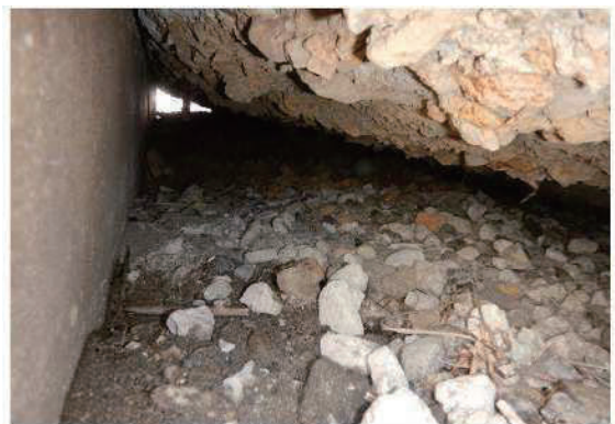
写真-42 踏掛版下の空洞
