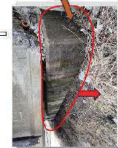
⑧伸縮部A1側 近間の異常 一道路部修繕
