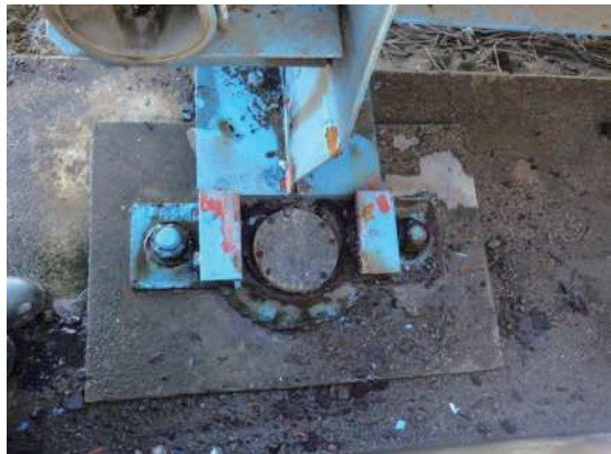
写真-9 才田大橋 支承破損・桁ウェブ座屈
