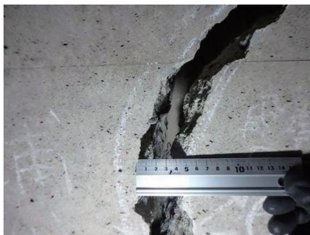
写真-6 輪切り状ひび割れ(最大幅 50mm)
