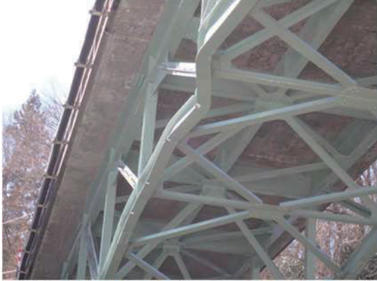
写真-1 鋼アーチ部材の変形状況
