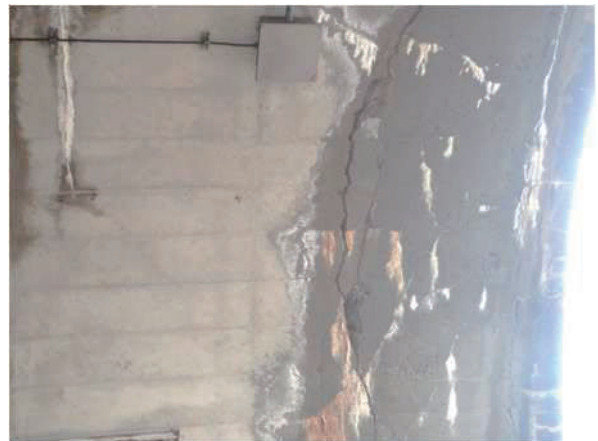
写真-21 ひび割れ状況
