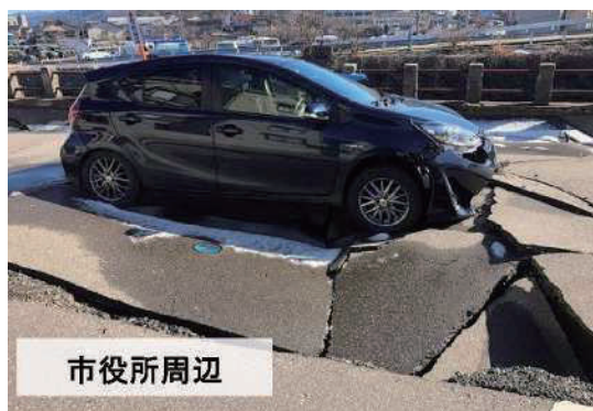
写真-2 道路崩壊 2)
