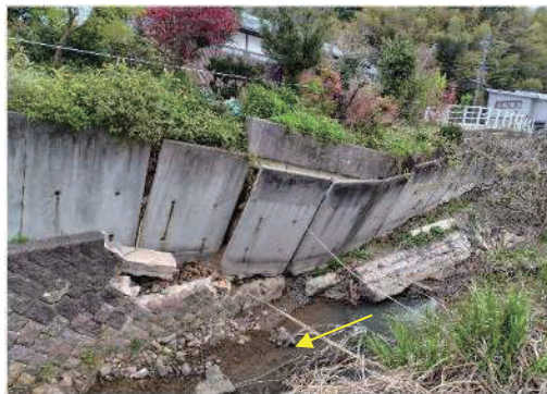
写真-5 護岸被災 (久田川 (右岸))
