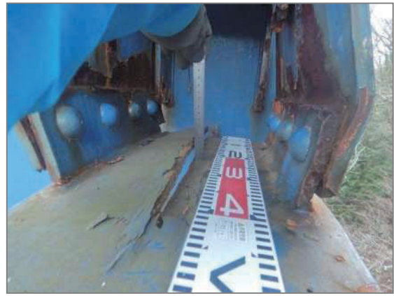
写真-4 下支材の亀裂
