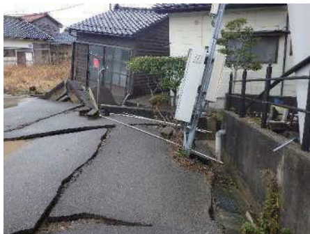
写真-6 液状化地区の被災状況
