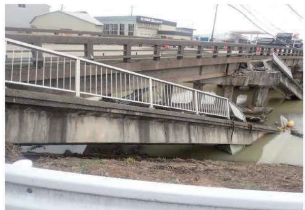
写真-6 桁の落下
