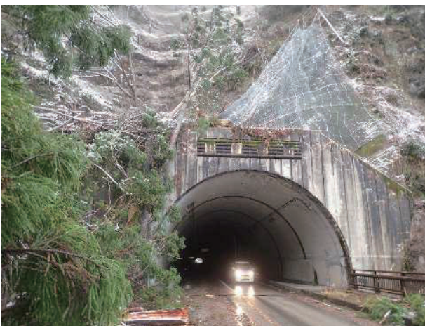
写真-14 穴水側坑口上部の斜面崩壊
