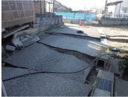
写真-4 液状化地区の被災状況
