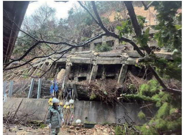
写真-3 大谷1号(珠洲市大谷町)の被災状況 (石川県提供)
