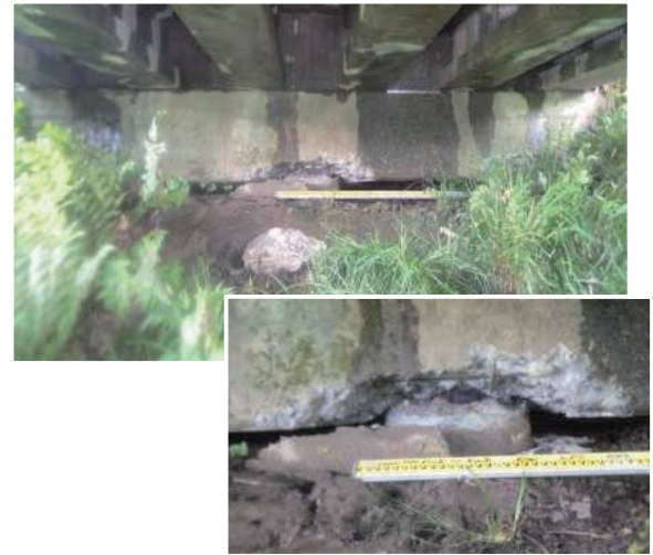
写真-23 パイルベント橋台杭頭部の剥離
