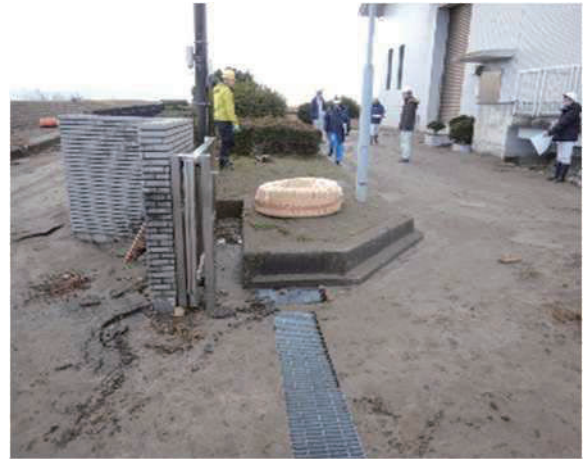
写真-4 津波による土砂堆積 (珠洲市熊谷汚水中継ポンプ場)
