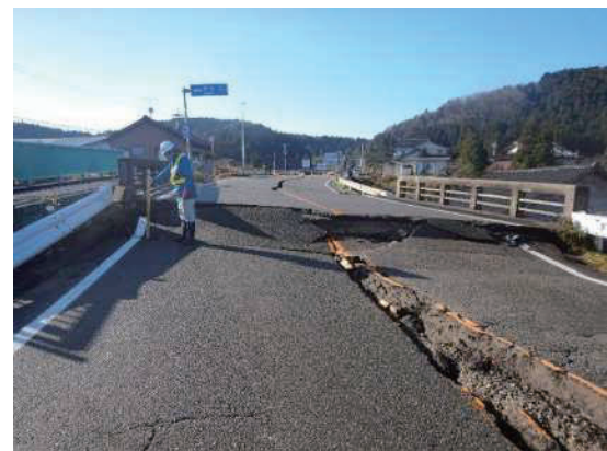
写真-36 橋台背面の段差
