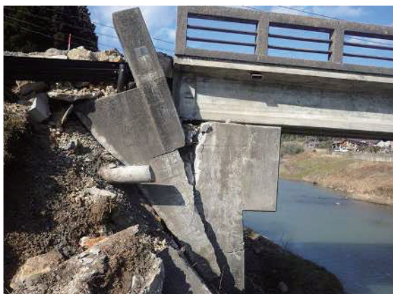
写真-14 胸壁の傾倒・破壊
