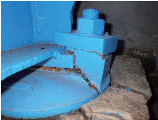
写真-32 支承・沓座モルタルの破損
