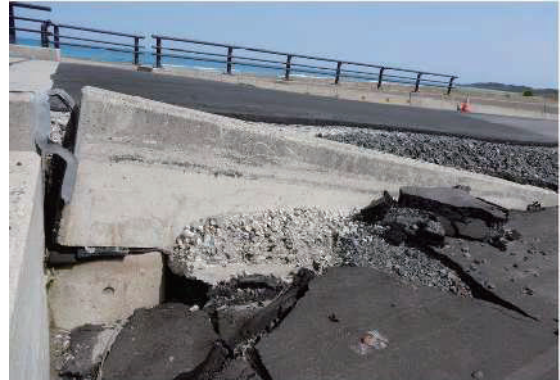
写真-41 踏掛版の傾斜
