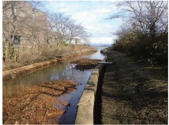
写真-7 矢板護岸の傾倒（潮津町）
