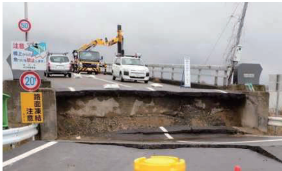
写真-7 才田大橋 橋台背面沈下
