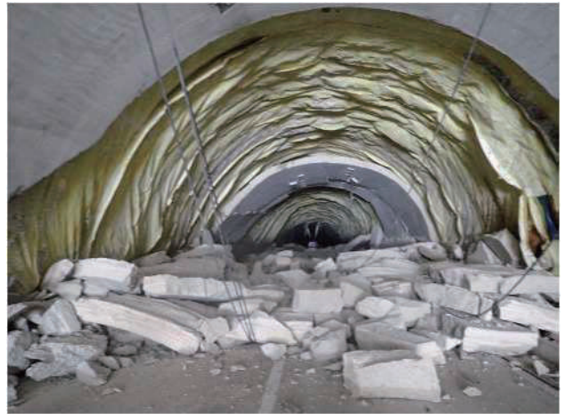
写真-2 大谷トンネルの被害状況
