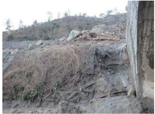
写真-26 珠洲側坑口斜面の崩壊
