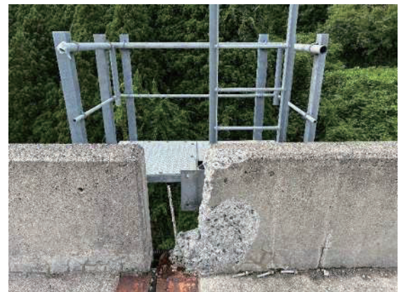
写真-49 検査路定着アンカーの脱落
