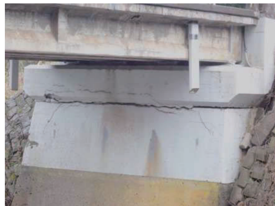
写真-12 打継部の開口
