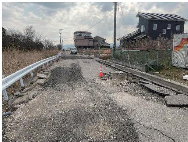
写真-2 市道石崎38号線の道路下水被災状況
