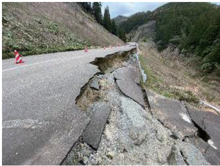
写真-10 広域農道の被災状況
