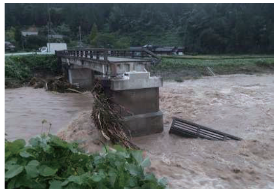
写真-55 上部工の流失 (橋梁正面) 1)
