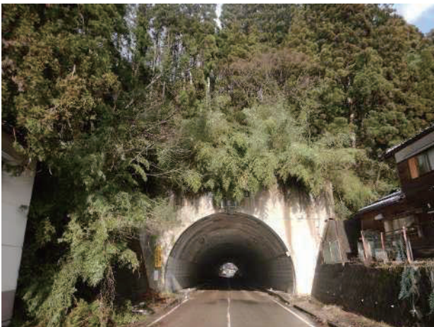
写真-19 柳田方面の坑口斜面の土砂崩れに伴う樹木の倒れ込み
