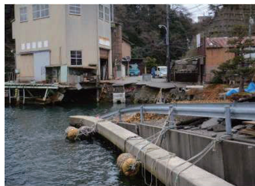
写真-3 海岸護岸矢板変状による町道崩壊（町道小木市之瀬1号線）
