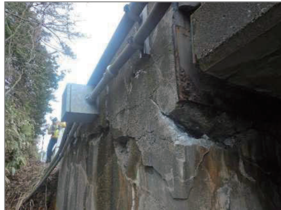
写真-16 翼壁の割れ・剥離
