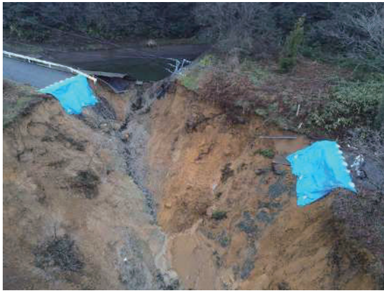
写真-4-2 盛土箇所の崩壊（豊町）
