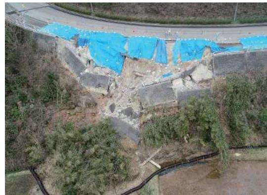
写真-7 擁壁被災状況
