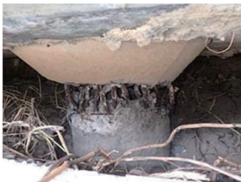
写真-5 地震動による橋台の座屈 (酒見大橋)
