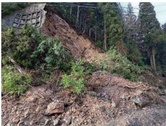
写真-6 切土被災状況
