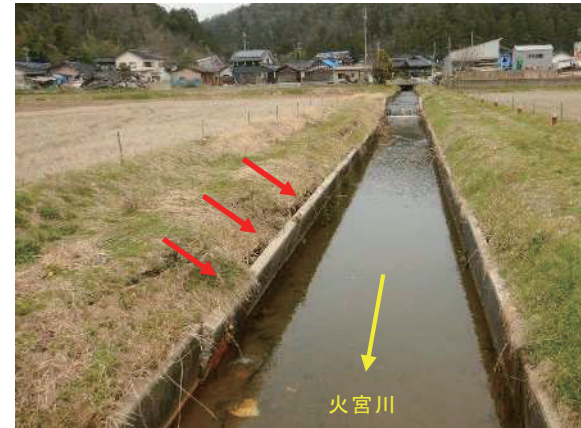
写真-12 重力式擁壁傾倒
