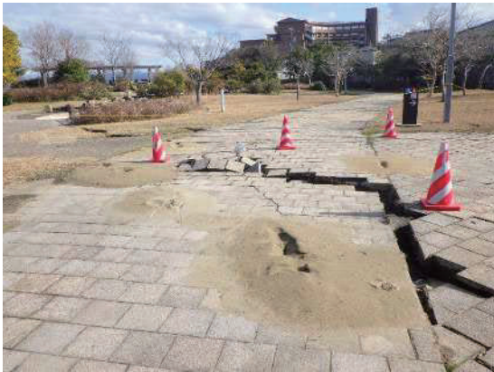
写真-5 園路の亀裂, 噴砂(柴山潟湖畔公園)
