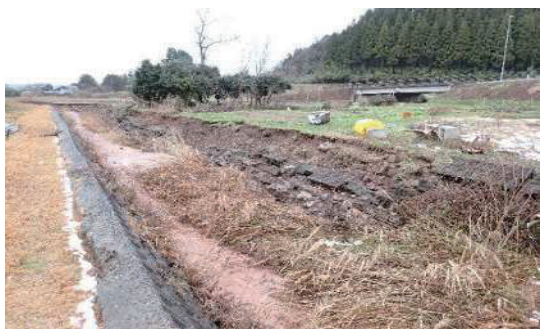
写真-6 河川護岸の倒壊
