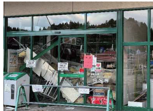
図-2 被災して営業停止となったスーパー
