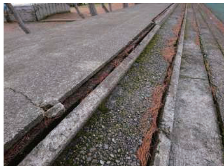
写真-3 陸上競技場観覧席の被災状況
