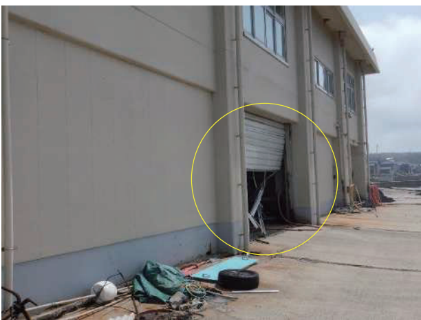
写真-4 津波の痕跡
