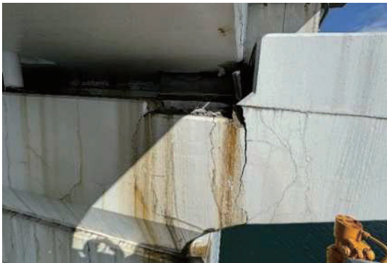
写真-21 橋脚梁のひび割れ
