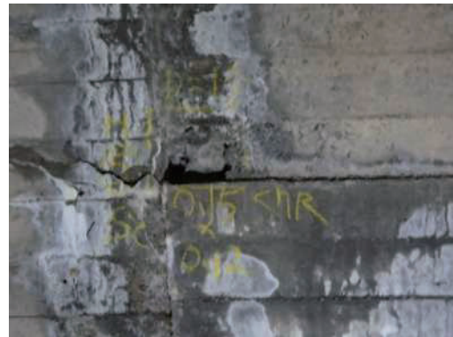
写真-31 アーチ部にある覆工のうき
