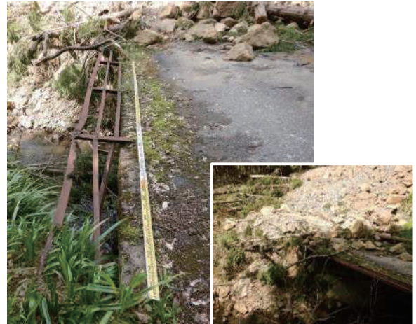
写真-47 防護柵の倒壊
