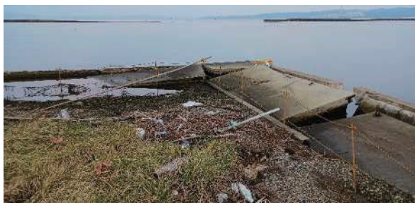
写真-9 液状化による護岸の変状
