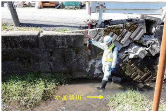
写真-9 ブロック積ひび割れ・欠損
