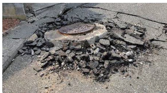
写真-8 マンホールの浮き上がり
