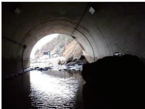
写真-24 土砂堆積・滞水状況
