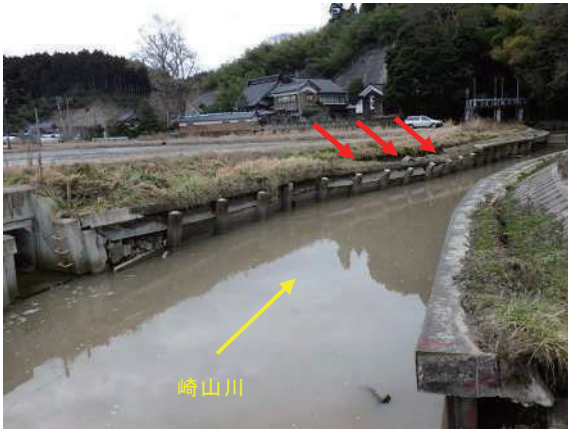
写真-13 コンクリート矢板傾倒
