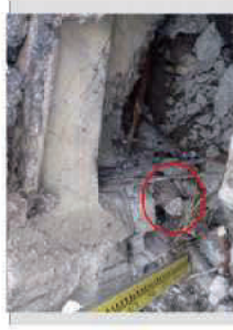
③主桁 破断、PCケーシング破断 一橋梁架替工
