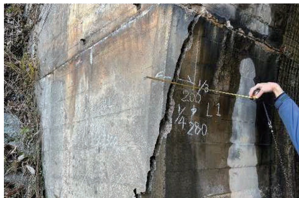
写真-11 七尾側坑門工 側壁部のうき
