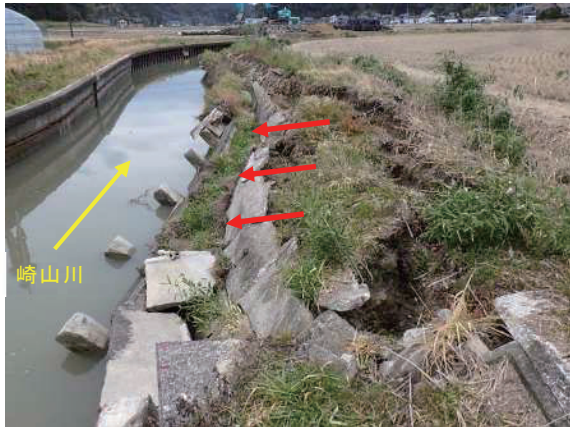
写真-14 矢板傾倒に伴う堤防崩壊
