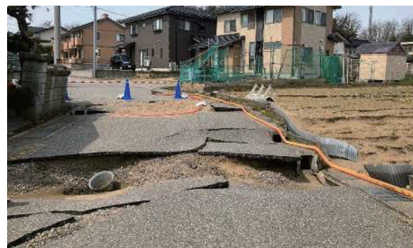
写真-6 側方流動に伴う道路の波状化
