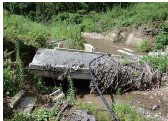
写真-5 RC床版橋の落下
