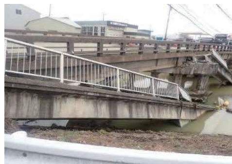
写真-5 歩道部の落橋
