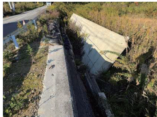
写真-8 擁壁被災状況
