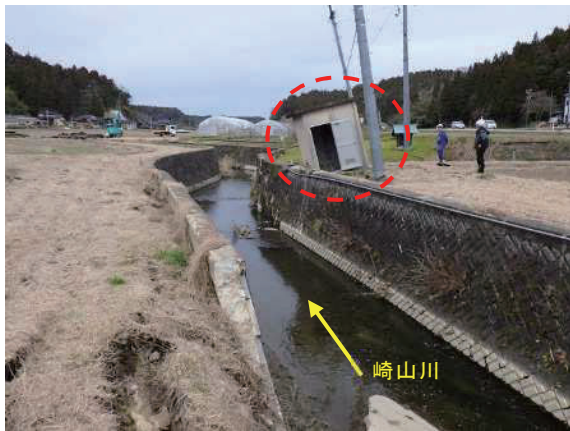
写真-19 水位局舎の傾倒 遠景
