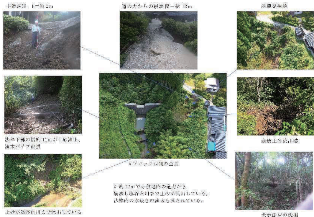
写真-6 能登町小間生地内の土砂災害
