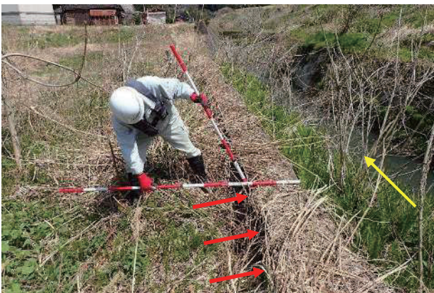
写真-21 背後地盤の沈下・陥没状況
