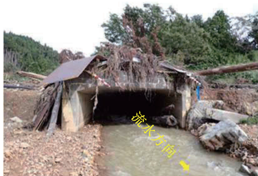
写真-53 橋面流木土砂堆積 (橋梁下流側面)
