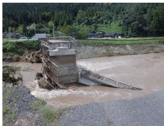
図-5 豪雨により被災した橋梁
