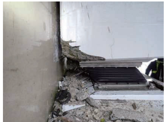
写真-34 ゴム支承の変形
