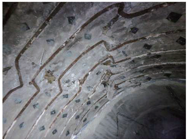
写真-3 中屋トンネルの被害状況
