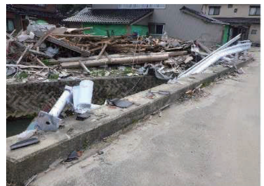
写真-9 津波による防護柵・地覆損傷 (向出橋)
