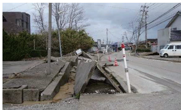
写真-5 側方流動に伴う歩道の隆起
