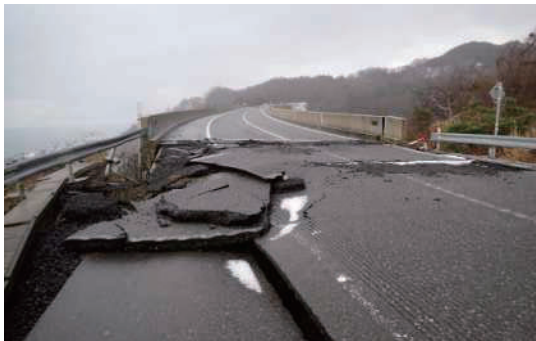
写真-39 橋台背面の陥没
