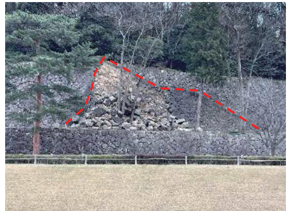
写真-12 金沢城跡石垣崩落
