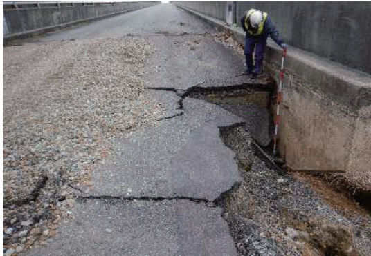
写真-37 橋台背面の陥没
