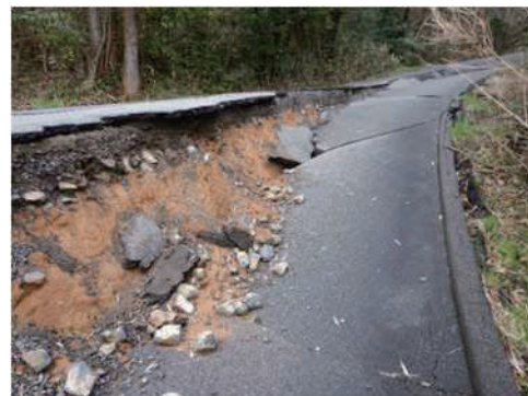
写真-10 林道大坂1号線被災状況
