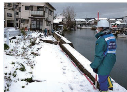
写真-3 河川の被災状況
