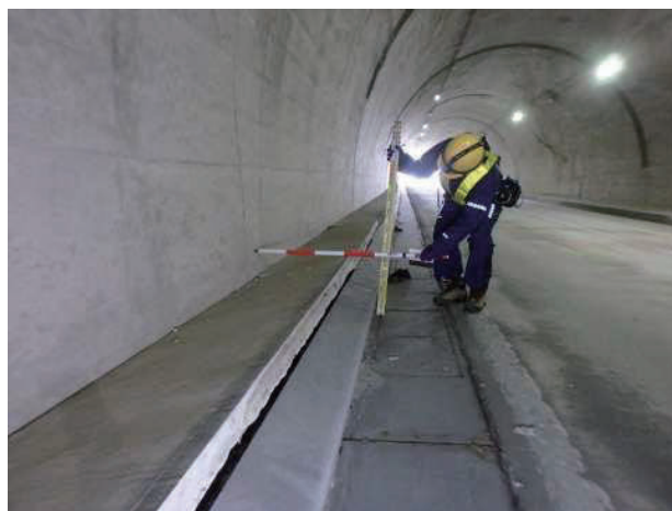
写真-8 監査廊の隆起
