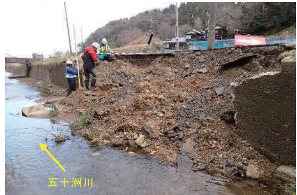
写真-10 重力式擁壁倒壊
