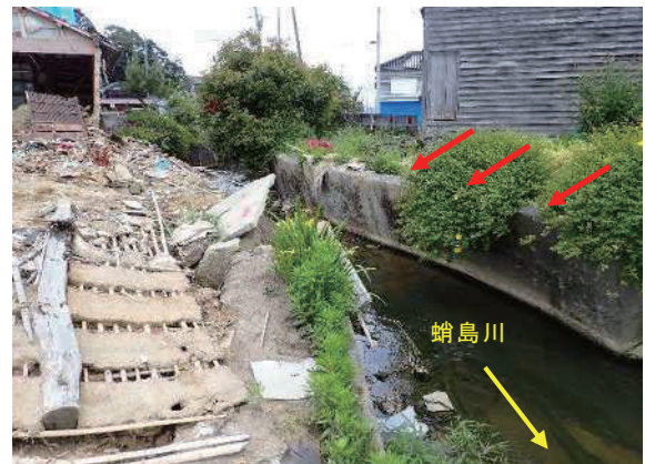
写真-11 重力式擁壁傾倒
