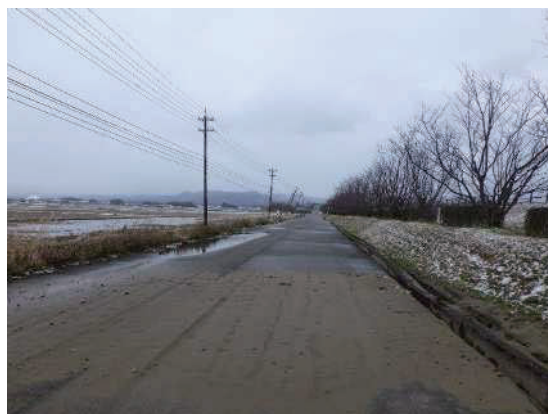
写真-3 路面の波打ち、噴砂（干拓町）
