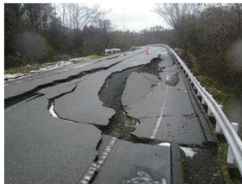
写真-8 町道鹿頭酒見線の被災状況
