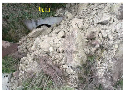
写真-1 岩盤崩壊（町道1級宇出津8号線（宇出津第3隧道））
