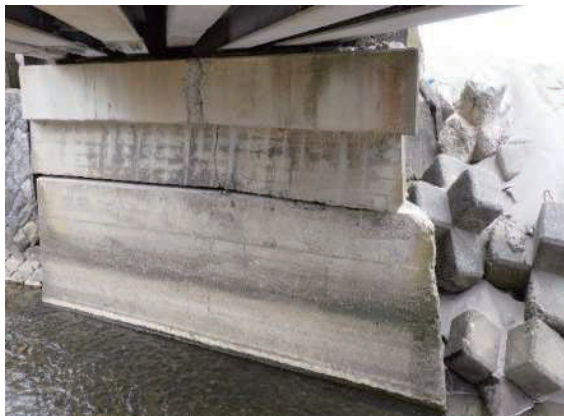
写真-13 縦壁のずれ
