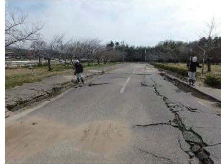
写真-12 液状化した町道の被災状況
