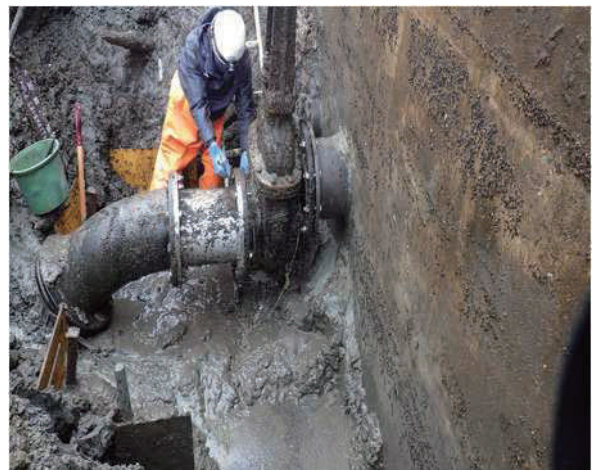
写真-5 水処理管のせん断破壊 (珠洲市浄化センター)
