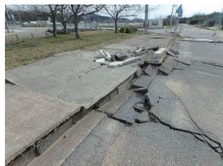
写真-8 町道の被災状況
