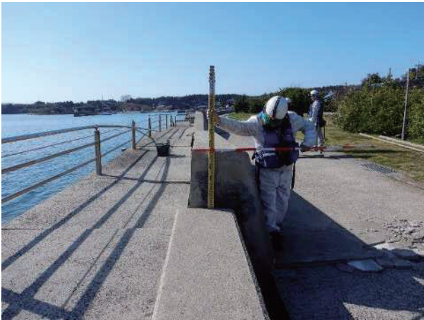
写真-2 胸壁工の沈下
