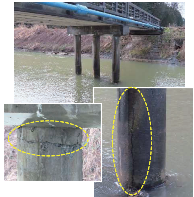
写真-24 パイルベント橋脚杭のひび割れ
