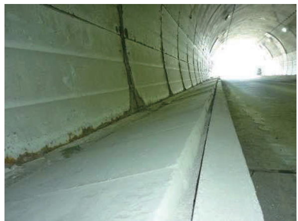
写真-22 監査廊の隆起
