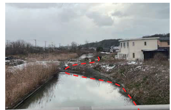
写真-6 西部承水路 河道閉塞(石川県提供)
