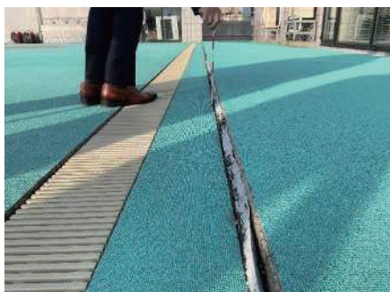
写真-4 プール施設の被災状況
