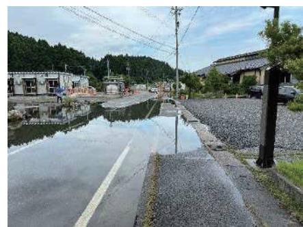
写真-9 広域的な沈下による被災状況
