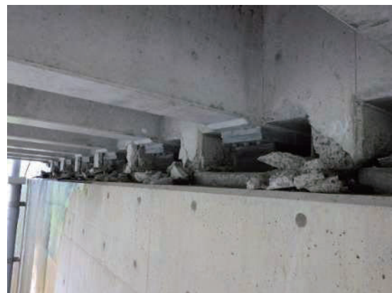
写真-35 変位制限構造の破損
