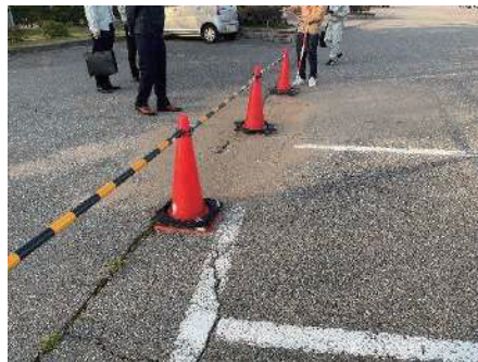
写真-5 駐車場の被災状況
