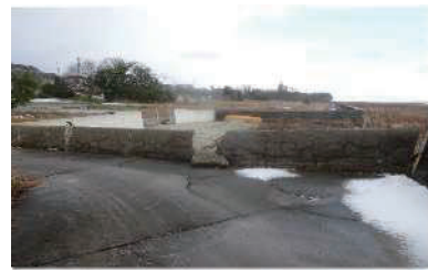
図-6 三崎海岸(堤防護岸・水叩き損壊) 6)
