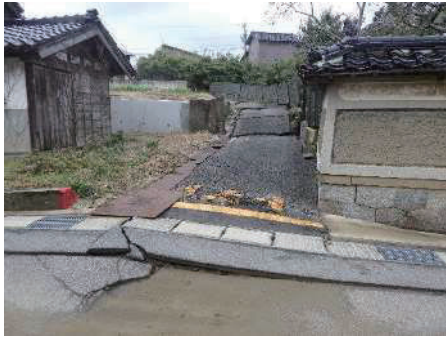
写真-9 町道の被災状況
