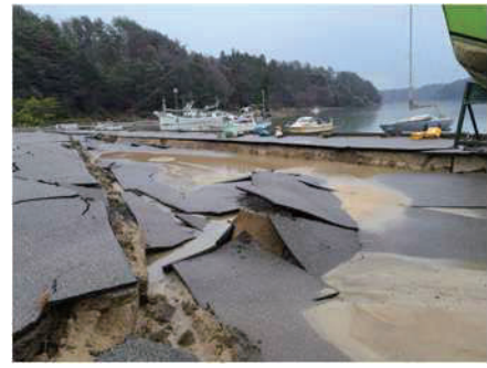
写真-7 港湾施設の被災状況
