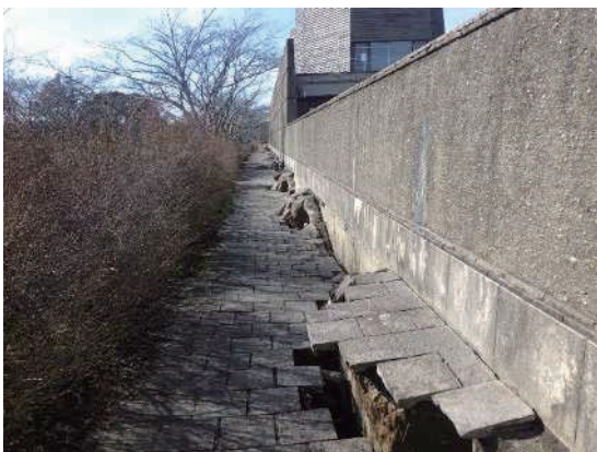
写真-6 舗装の沈下（雪の科学館）
