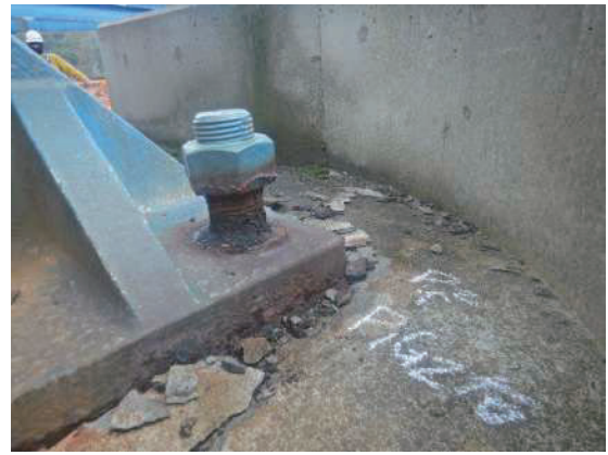
写真-28 アンカーボルトの抜け出し
