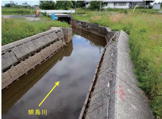
写真-7 大型ブロック積崩壊
