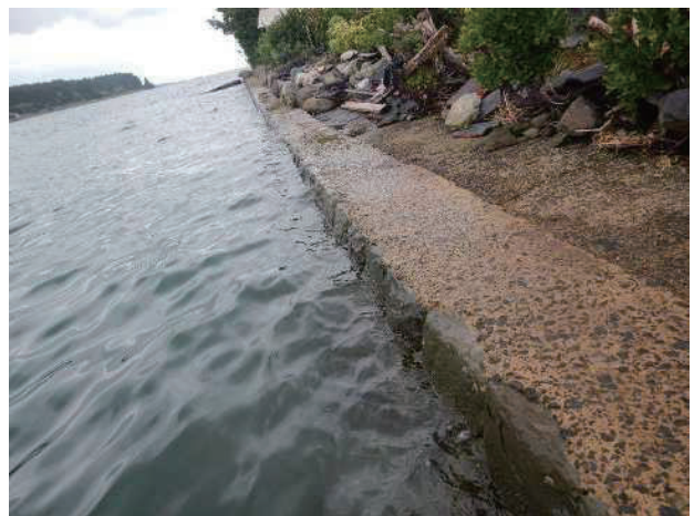
写真-6 沈下による天端高の不足
