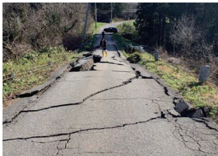
写真-1 町道の被災状況
