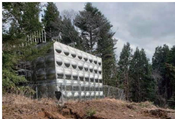
写真-2 ステンレスタンクの崩壊 (輪島市長沢配水池)
