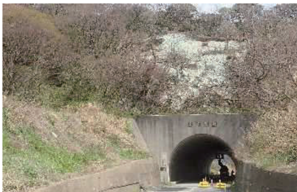
写真-9 輪島側坑口斜面の表層崩壊
