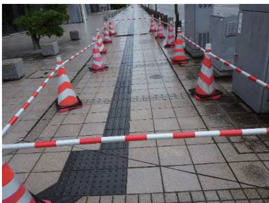
写真-1 融雪パネルの沈下（土居原町）
