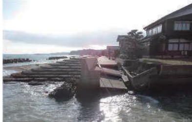
図-7 宝立正院海岸(堤防護岸損壊) 6)
