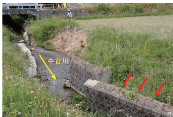
写真-3 ブロック積傾倒
