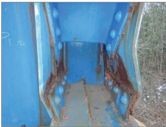
写真-2 ガセットプレートの変形
