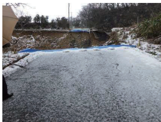
写真-4-1 盛土箇所の崩壊（豊町）
