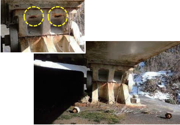
写真-26 セットボルトの破断
