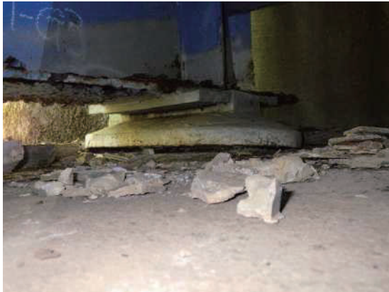
写真-31 沓座モルタルの破損・支承浮上り
