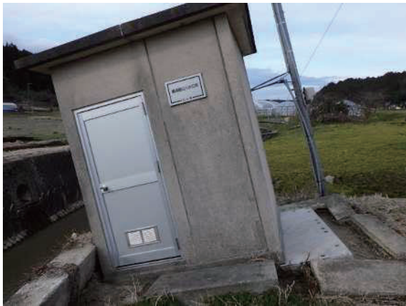
写真-20 水位局舎の傾倒 近景
