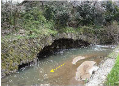
写真-4 護岸被災 (余ノ井川 (右岸))
