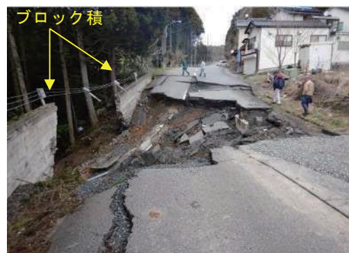
写真-2 路側擁壁倒壊（町道1級宇出津8号線）
