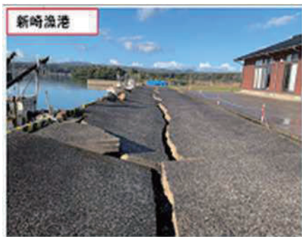
写真-5 漁港の被災状況
