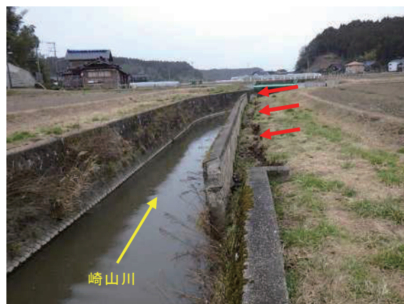
写真-2 ブロック積傾倒
