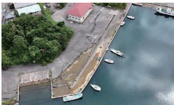
写真-10 液状化による護岸背面の亀裂・沈下
