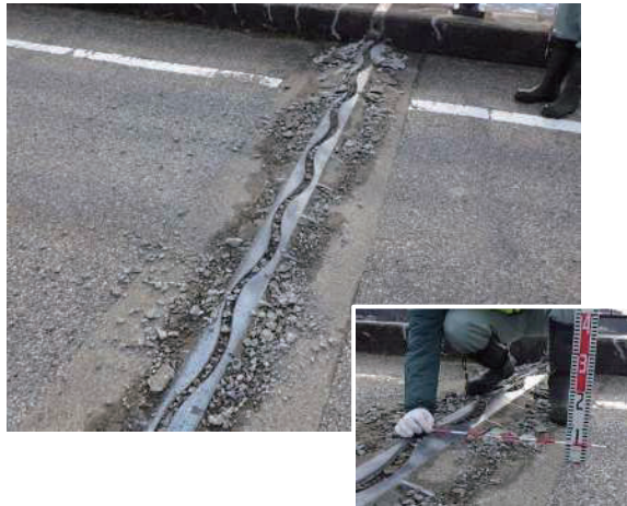
写真-45 伸縮装置の段差
