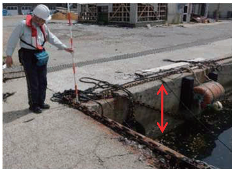
写真-1 物揚場の隆起 (赤崎漁港)
