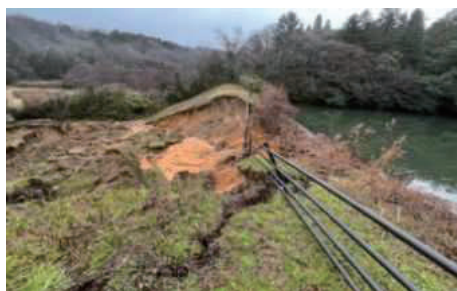
写真-2 損傷したため池
