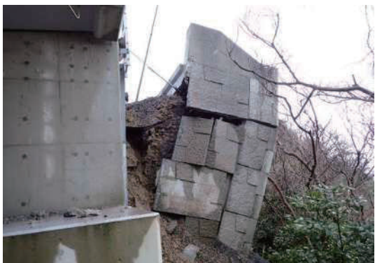
写真-40 補強土壁の崩壊
