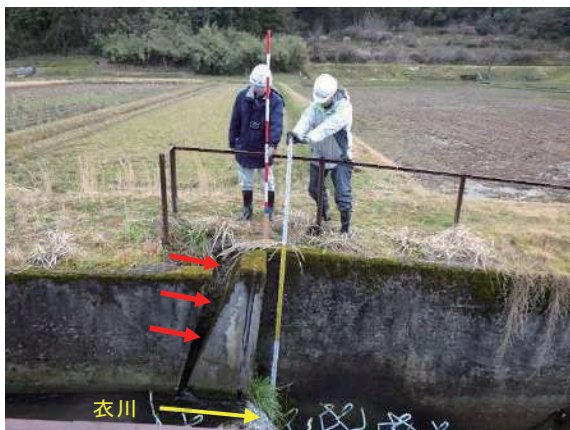
写真-15 落差工袖部倒壊
