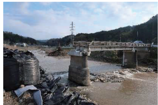
写真-56 上部工の流失 (橋梁側面) 1)
