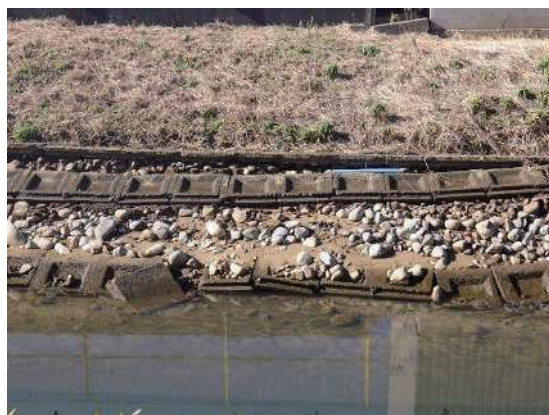
写真-2 護岸のはらみだし、土砂流出（浜田町）
