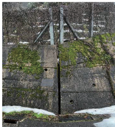
写真-4 地方(輪島市町野町粟蔵)の被災状況 (石川県提供)
