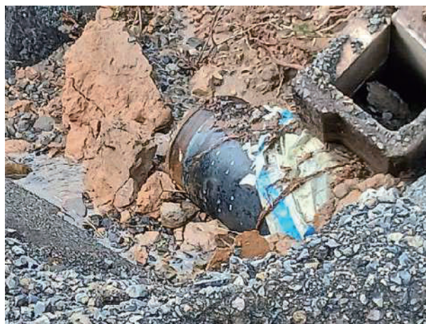
写真-1 道路崩壊による送水管の離脱 (輪島市内)
