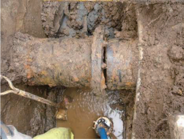
写真-3 ろ過水管の破損 (輪島市輪島浄水場)
