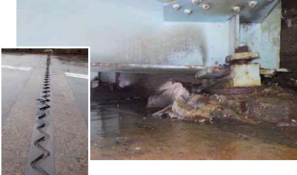
写真-25 支承部の破壊、伸縮装置の段差
