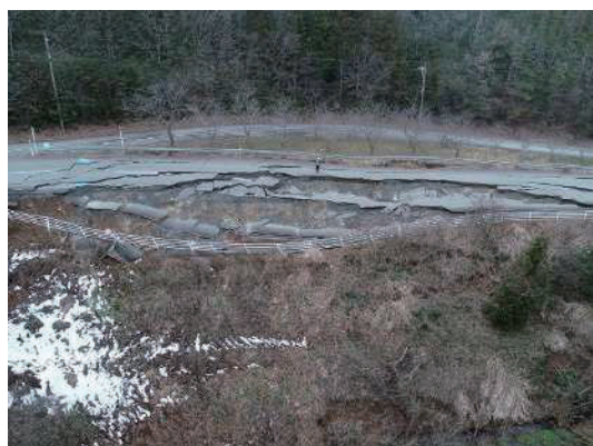
写真-1 盛土被災状況
