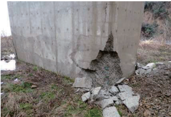
写真-20 橋脚柱の剥離・鉄筋露出
