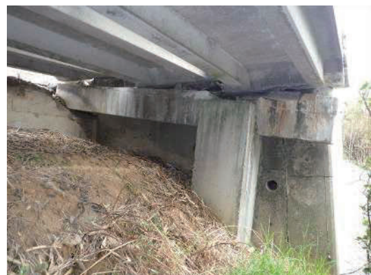
写真-9 張り出し歩道被災状況
