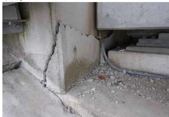
写真-15 胸壁の割れ・剥離
