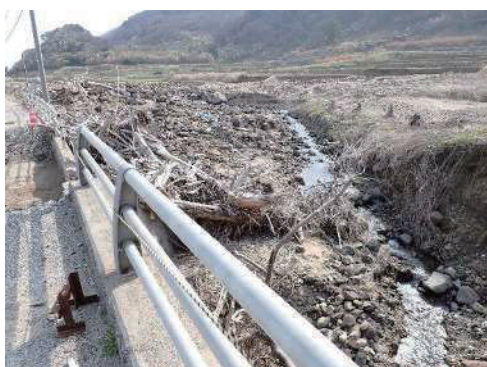
写真-6 土砂流入による河道の閉塞
