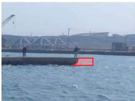
写真-2 津波による突堤頭部の消失 (高浜漁港)
