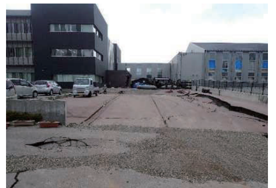
写真-9 教育施設の被災状況(輪島中学校)
