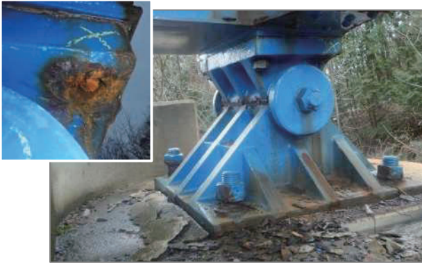
写真-27 セットボルトの破断・アンカーボルトの抜け出し・沓座モルタルの破損
