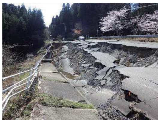
写真-3 盛土被災状況
