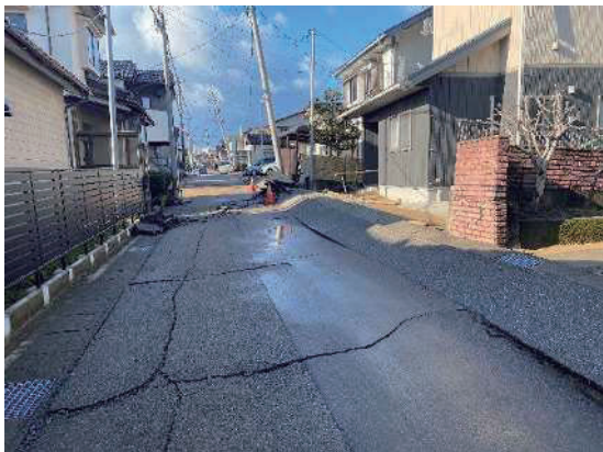
写真-2 栗崎地区液状化(金沢市提供)
