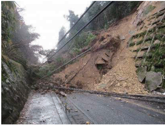
写真-4 切土被災状況
