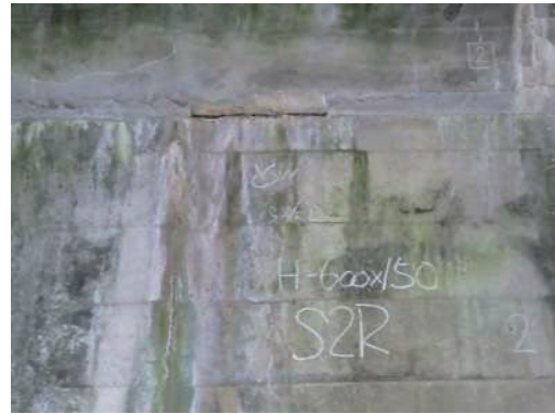
写真-30 水平打継目のうき・はく離
