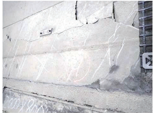
写真-15 側壁部のうき
