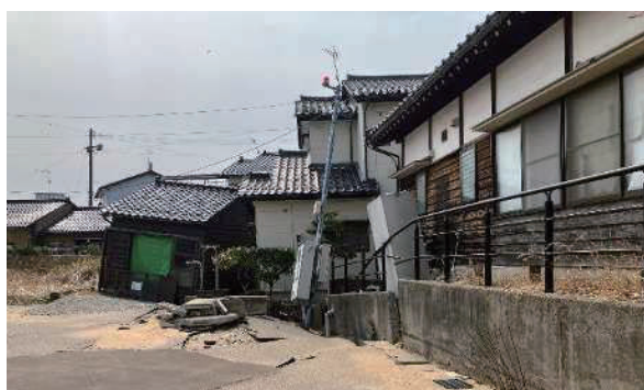
写真-3 宅地の不同沈下・傾斜
