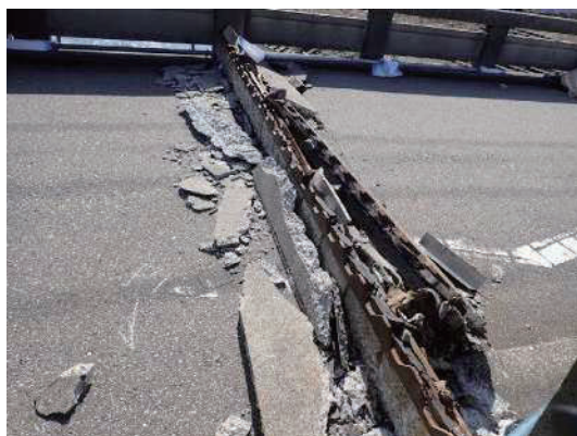
写真-46 伸縮装置の破壊
