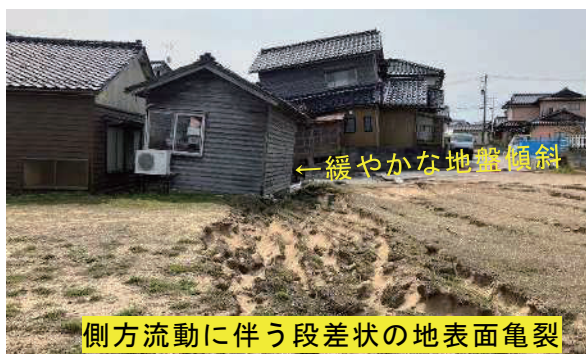
写真-4 段差状の地表面亀裂
