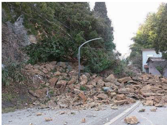
写真-5 切土被災状況
