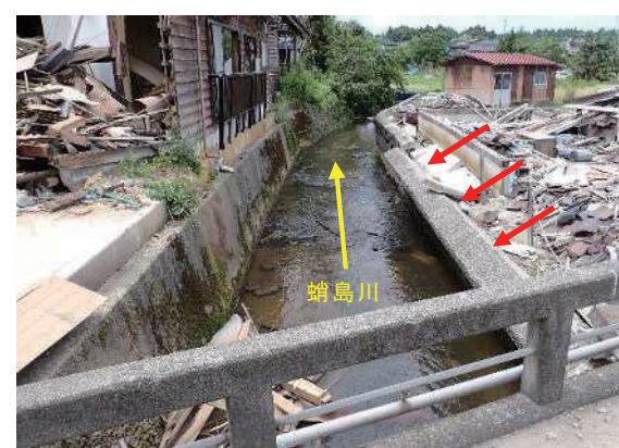
写真-4 ブロック積傾倒
