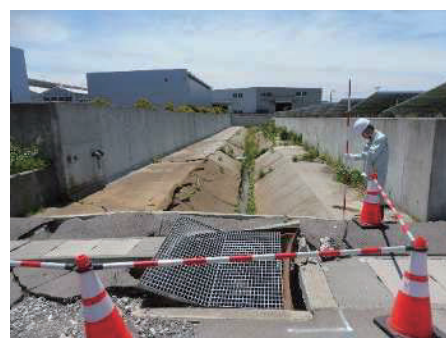
写真-3 農業用排水路の被災状況
