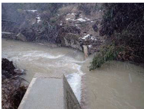
写真-8 護岸の大規模崩壊
