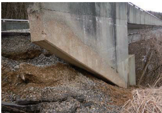
写真-38 翼壁下端からの土砂流出
