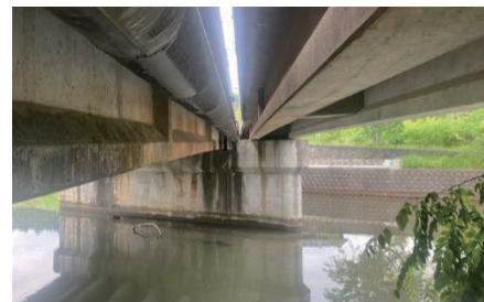
写真-2 橋梁の被災状況
