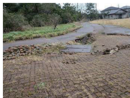
写真-2 白鷺公園の被災状況
