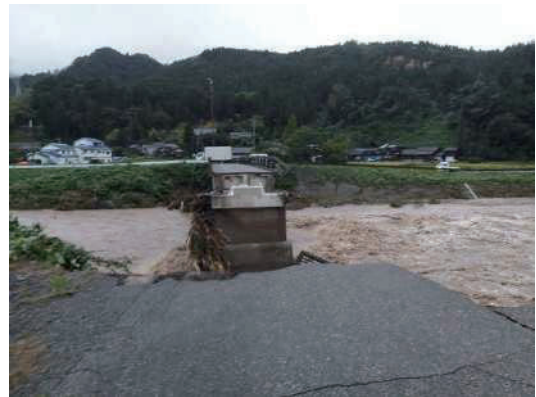
写真-54 上部工の流失 (橋梁正面) 1)
