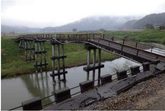
写真-19 パイルベント橋脚の変位
