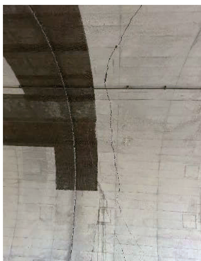
写真-10 アーチ全周の斜め輪切り状ひび割れ
