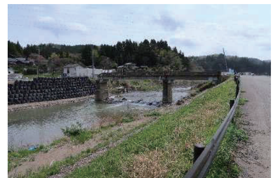
写真-57 上部工の流失 (橋梁側面) 1)
