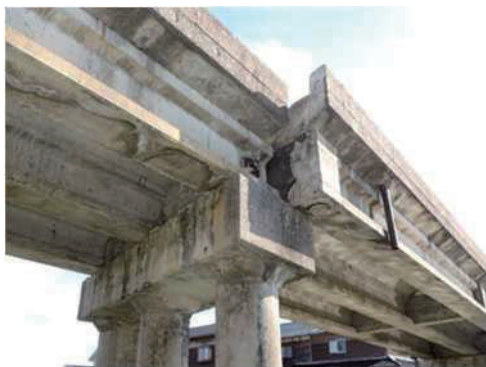
写真-6 地震動による上部工水平移動 (大橋詰橋)
