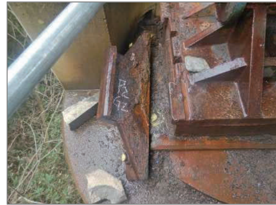
写真-29 サイドブロックの破損
