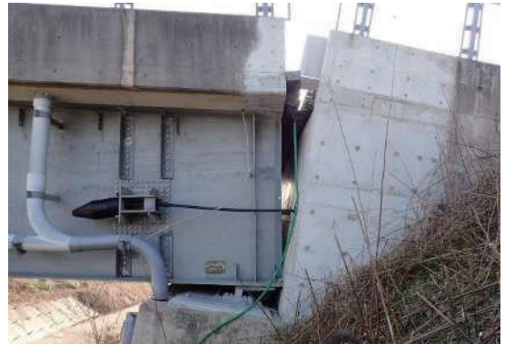
写真-7 落橋の状況(花山橋)
