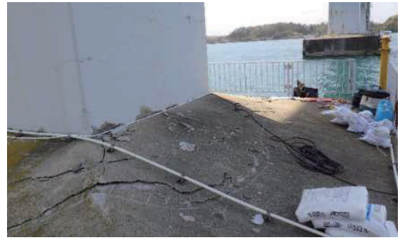
写真-22 橋脚底版のひび割れ・剥離
