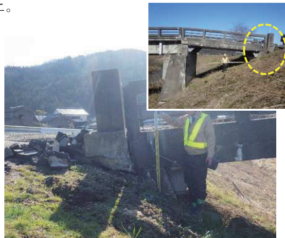
写真-17 橋台の沈下
