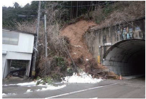
写真-20 曾々木方面の坑口斜面の土砂崩れ
