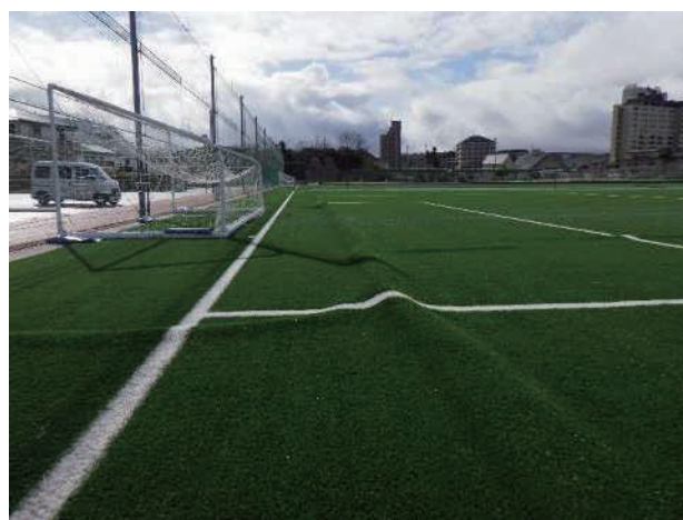
写真-4 和倉サッカー場グラウンドの被災状況
