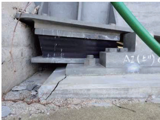
写真-33 ゴム支承の変形
