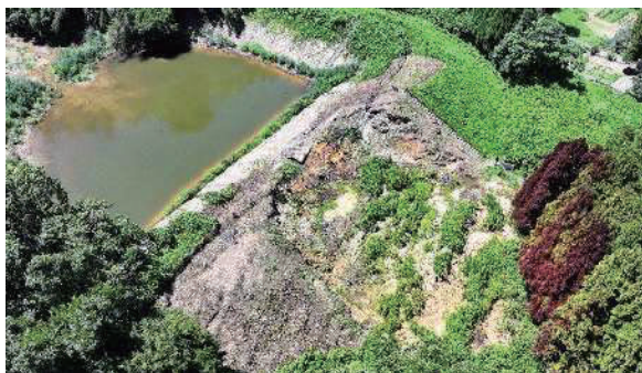
写真-11 中谷内池の被災状況
