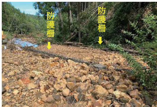
写真-51 河川断面埋塞 (橋梁上流側面)
